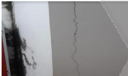
Fissura na Parede USF Castanheira
