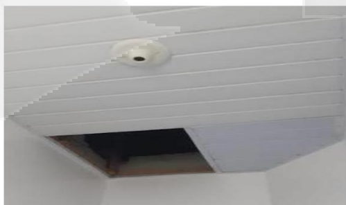
Alçapão sem tampa forro sala PCCU da USF Castanheira
