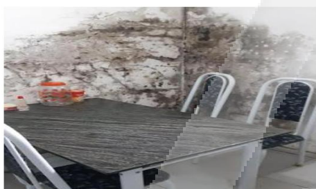
Paredes com fungo USF Aeroporto
